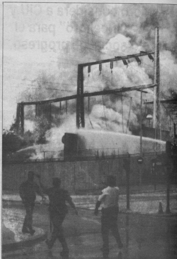
Incendio en el transformador de la compañía Fecsa.
