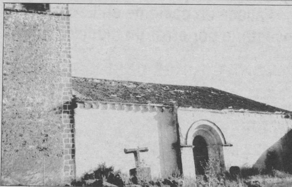
Imagen del estado en que se encuentra el tejado de la iglesia.
