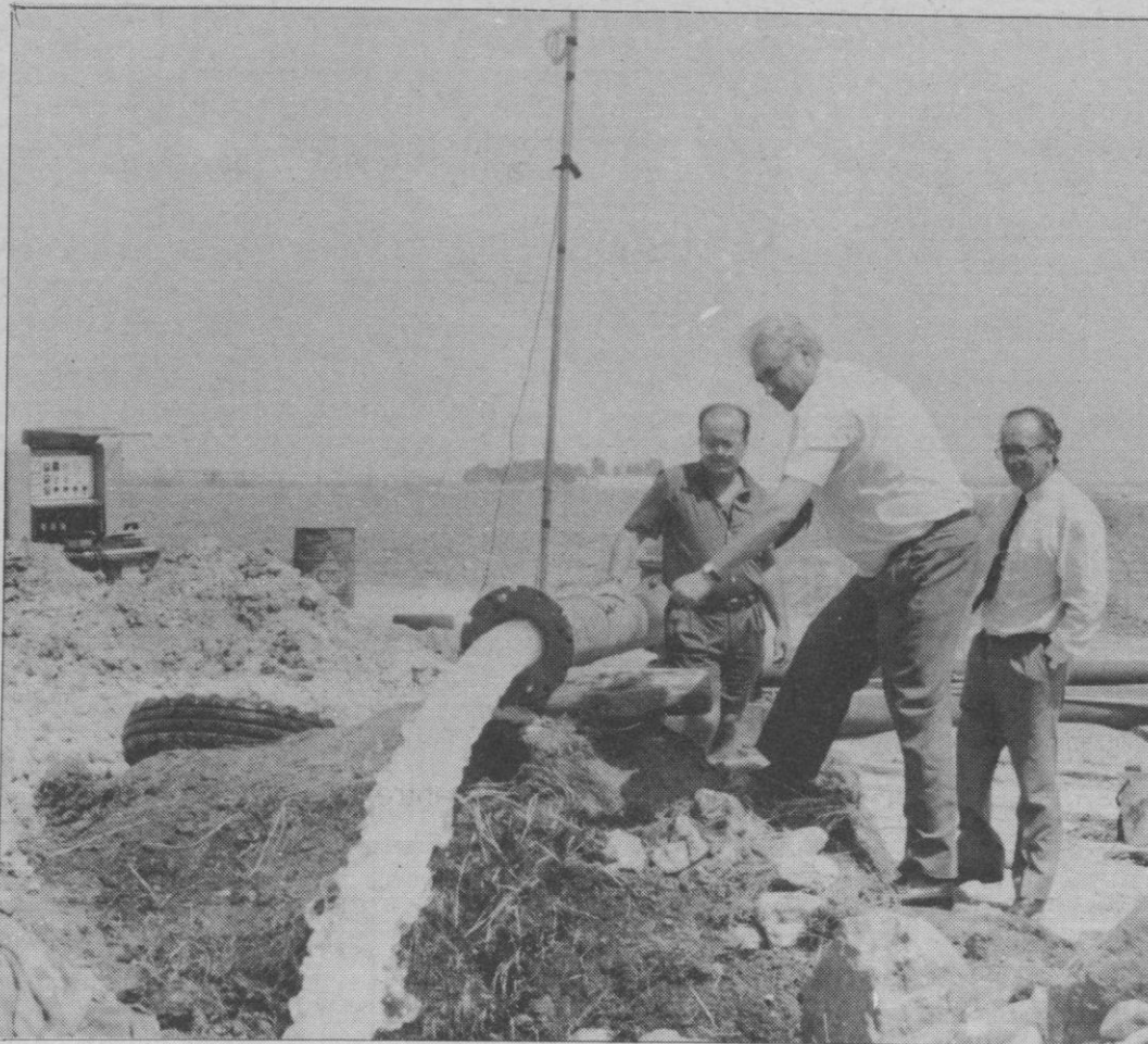
En un futuro, este pozo suministrará agua al barrio de Madrona.
