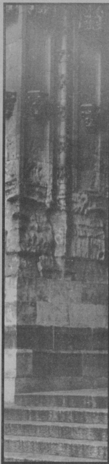
En los bajos se ha colocado un zócalo de granito, sin cortar la piedra, por lo que la humedad sigue subiendo.
