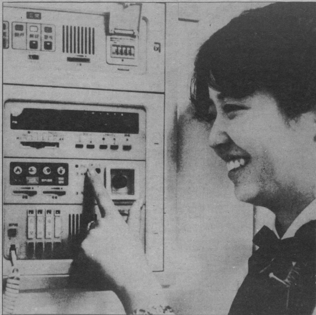
Ordenador doméstico de Matsushita, con diversas aplicaciones tales como advertir de incendios, escapes de gas, presencia de intrusos, etc.—(Foto EFE)
