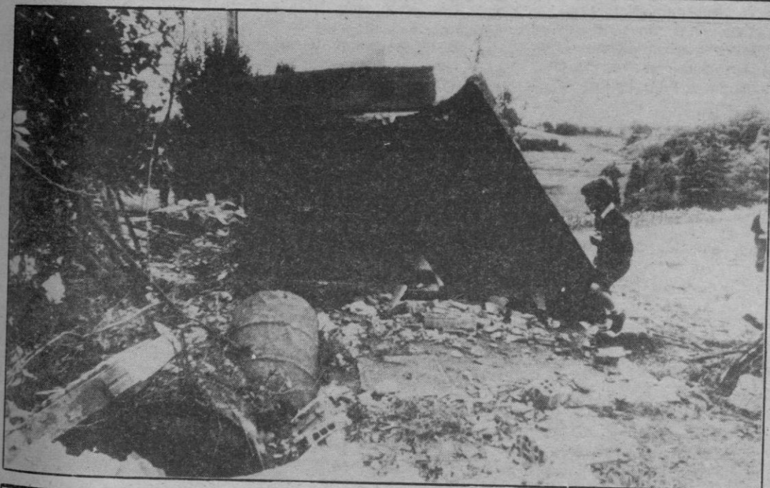
San Sebastián. — Estado del centro de transformación de «Iberduero» en el barrio de Ayete tras el atentado ocurrido ayer. Otros cinco artefactos explosionaron en diferentes instalaciones de esta empresa en Guipúzcoa.
