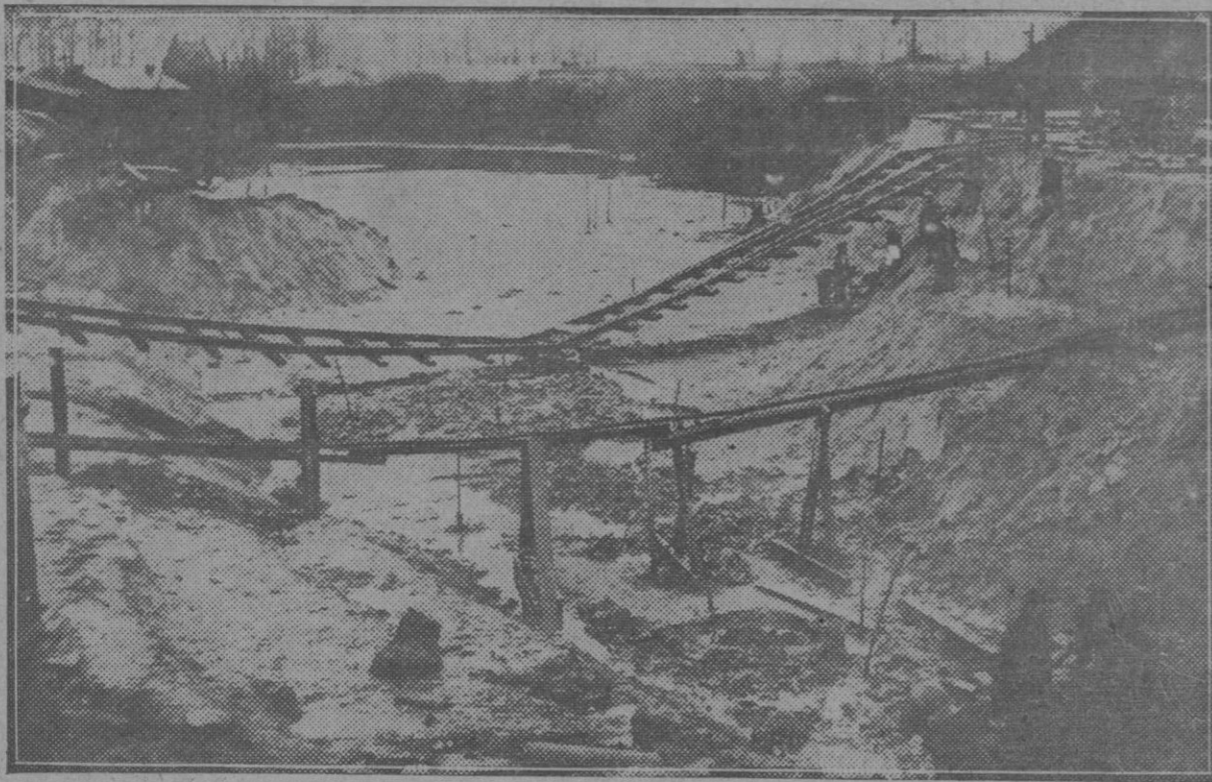
Una línea férrea destrozada en Holanda por las inundaciones. Actualmente se trabaja en repararla
