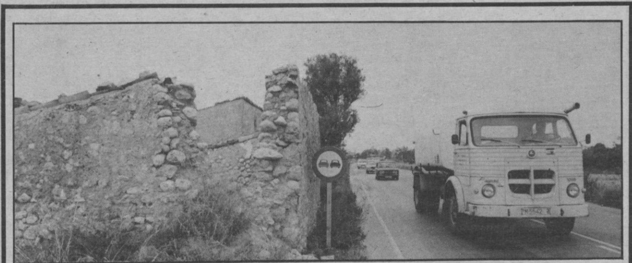
Una pared «flotante» y peligrosa en la carretera Inca-Palma. — (Foto Reportajes QUETGLAS).
