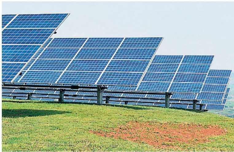
Imagen de archivo de una instalación fotovoltaica en la provincia. E. A.
