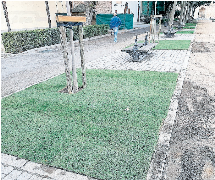
Imagen de los nuevos tepes instalados en el Paseo del Salón. EL ADELANTADO
