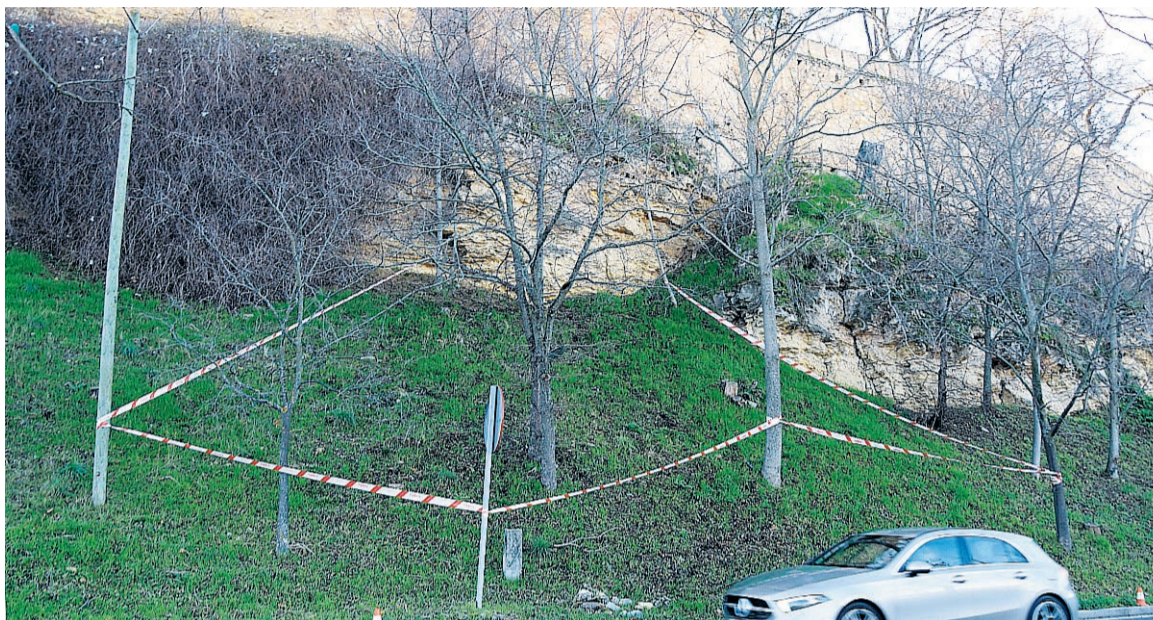
La zona donde se produjo el desprendimiento el pasado jueves permanece acordonada.
