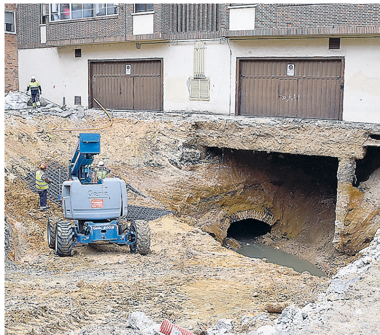
Imagen del enorme socavón aparecido en la capital segoviana. / ROCÍO PARDOS
