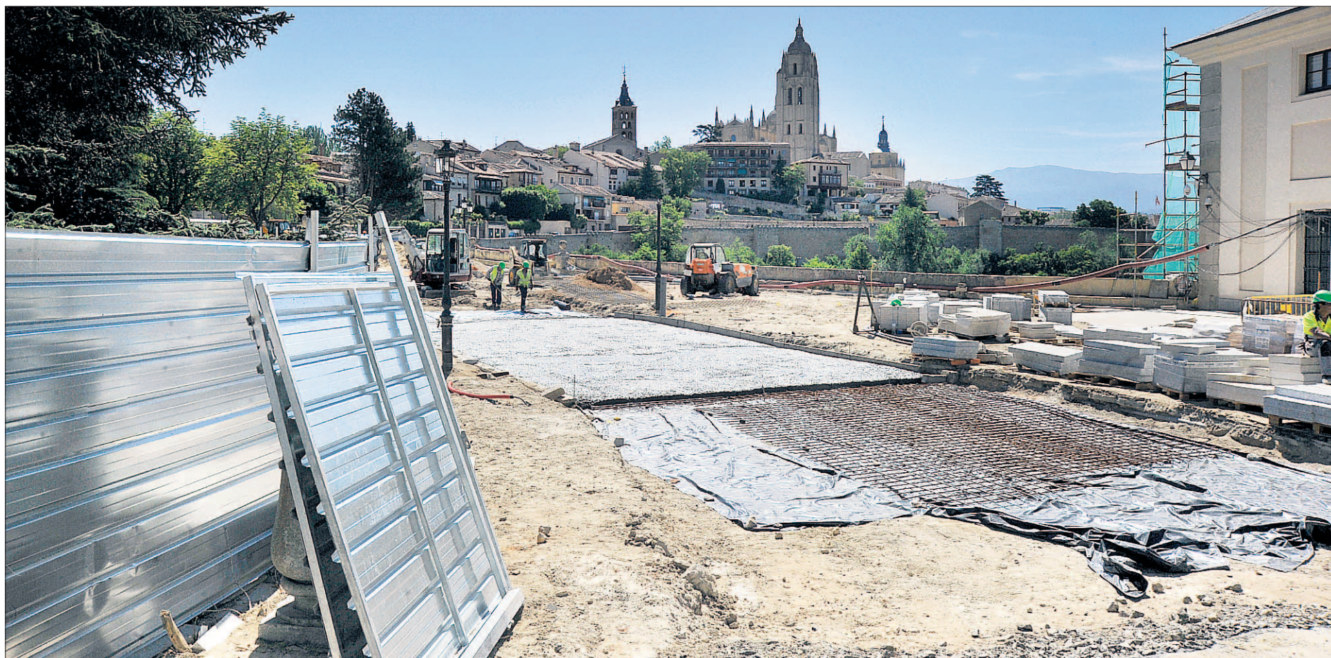
Las obras en la plazuela avanzan a buen ritmo y de momento cumplen los plazos establecidos. / KAMARERO
