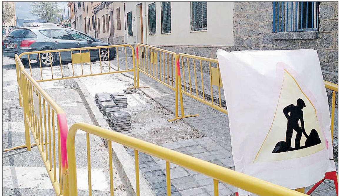
Tramo de acera pendiente de pavimentar en la calle de Tejedores, a falta del suministro de baldosas de botón. / E. A.
