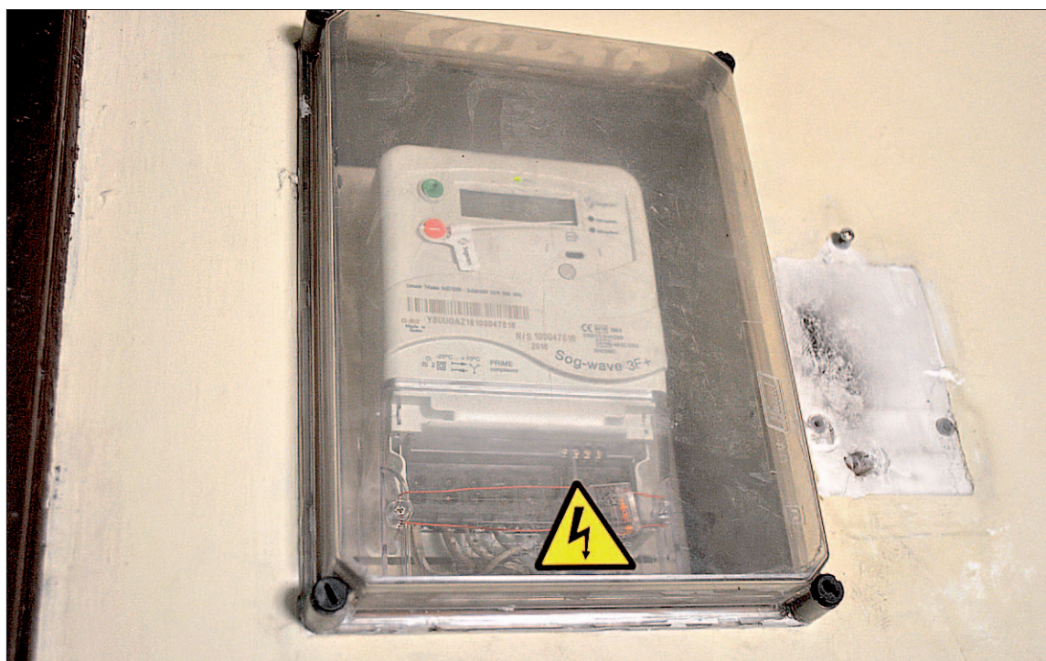
Uno de los contadores inteligentes que han tenido que ser sustituidos en la capital segoviana. / KAMARERO
