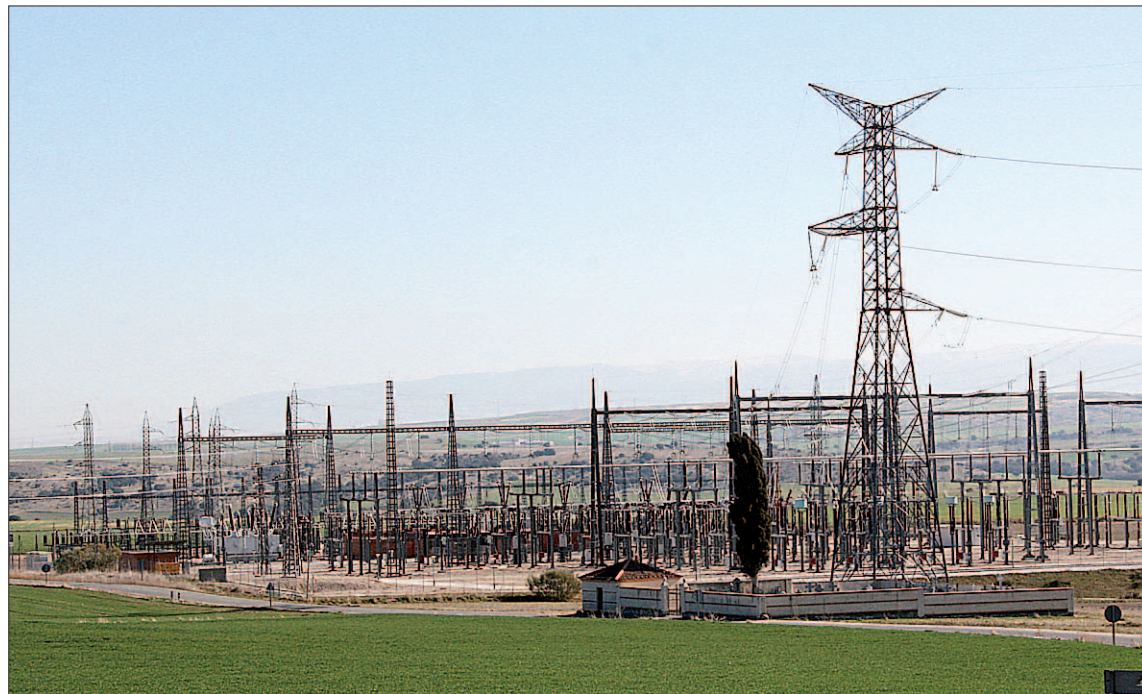
Imagen de la estación eléctrica de Lastras del Pozo, situada junto a la carretera de entrada al pueblo. / E. A.
