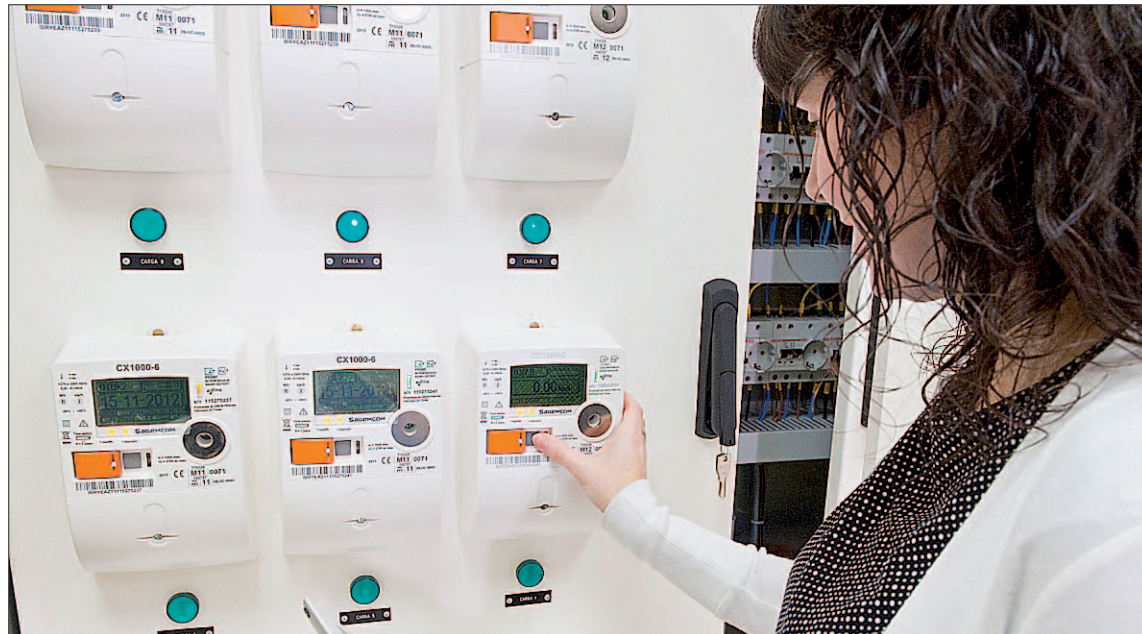
Un sistema de contadores inteligentes instalado por UFD. / EL ADELANTADO
