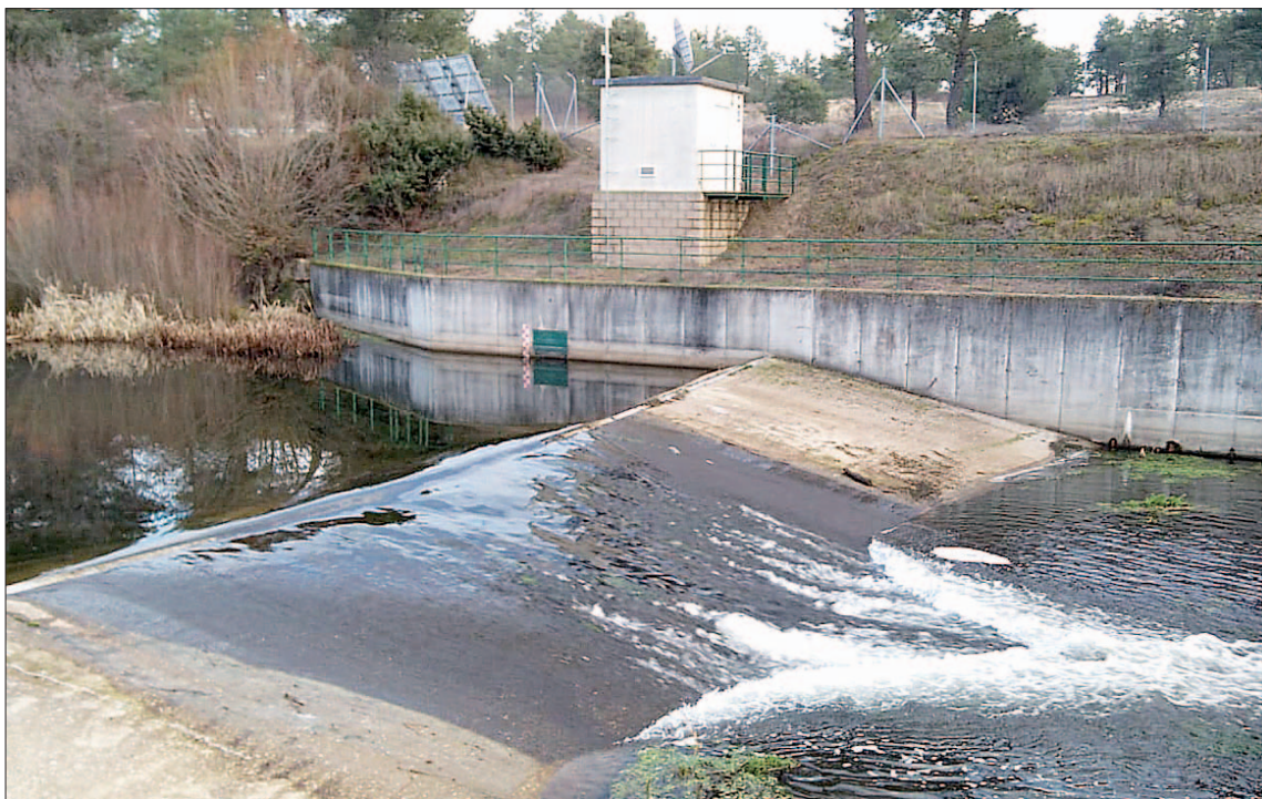
Estación de aforos de la Confederación Hidrográfica del Duero en el río Cega. / EL ADELANTADO
