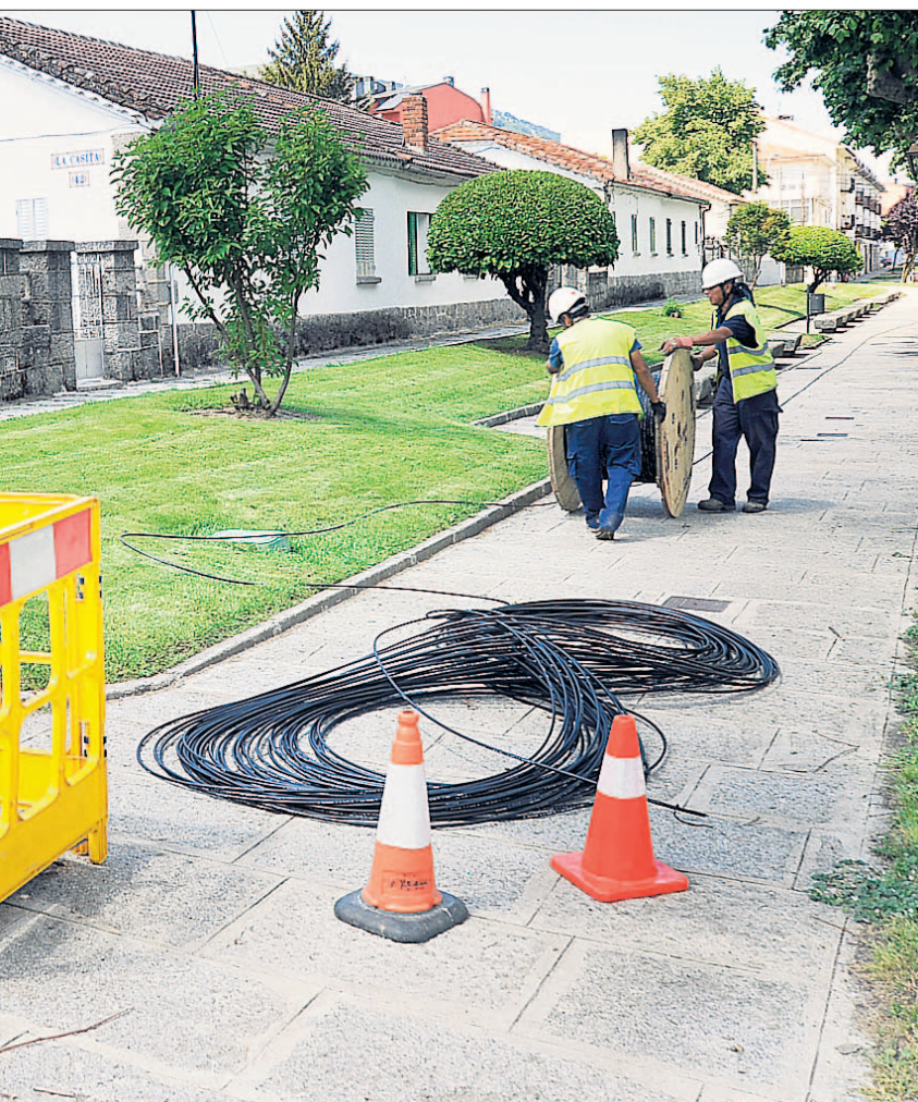
Estado en el núcleo de Los Angeles de San Rafael. / KAMARERO
