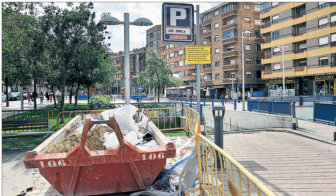
El Ayuntamiento ha tenido que acometer obras en el parking para solucionar, entre otros, problemas de humedad. / KAMARERO
