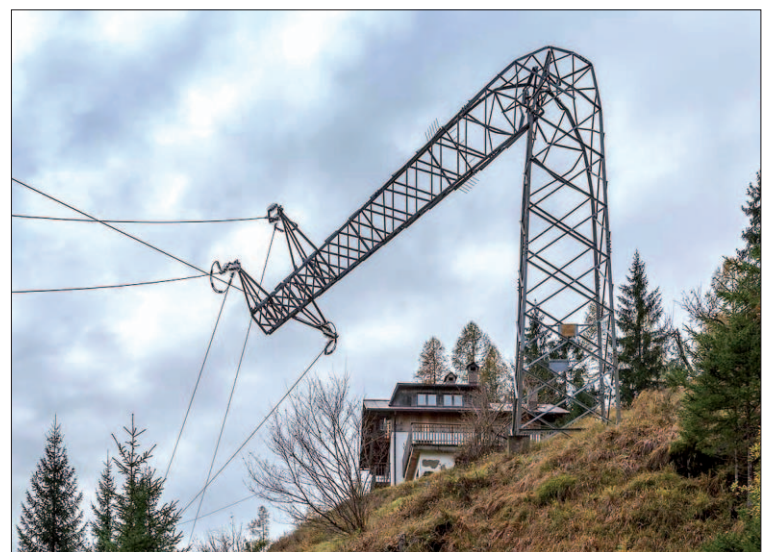
Una torre eléctrica doblada en Belluno a causa del temporal. / EFE
