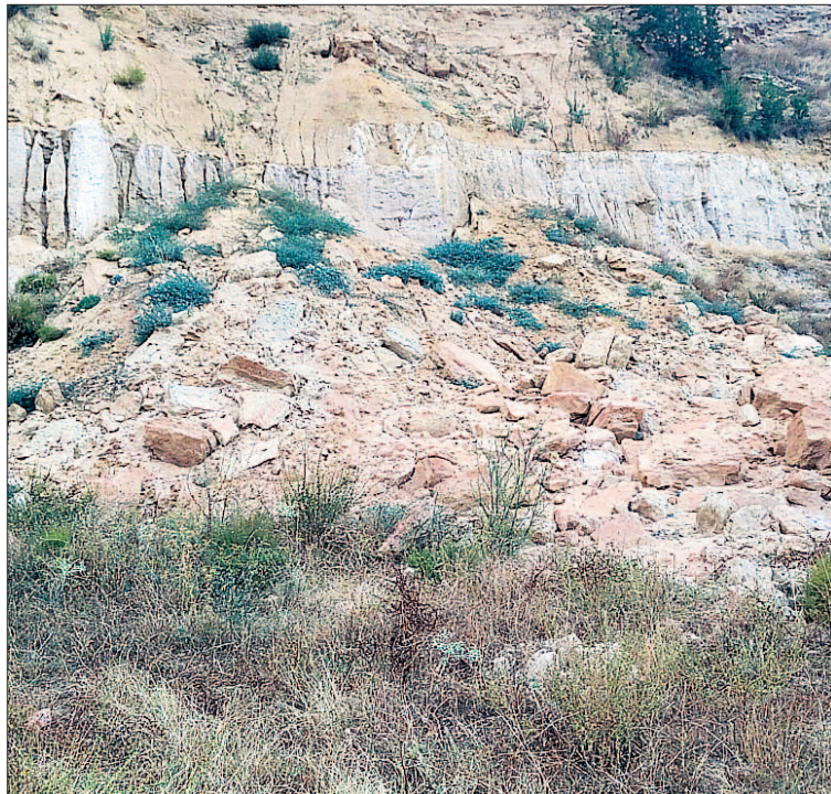
Imagen aportada por IU del talud en el mes de septiembre. /E.A.
