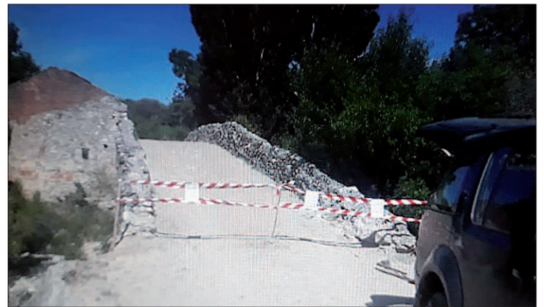
Imagen de las cintas que puso la Junta para impedir el paso por el puente. / E. A.
