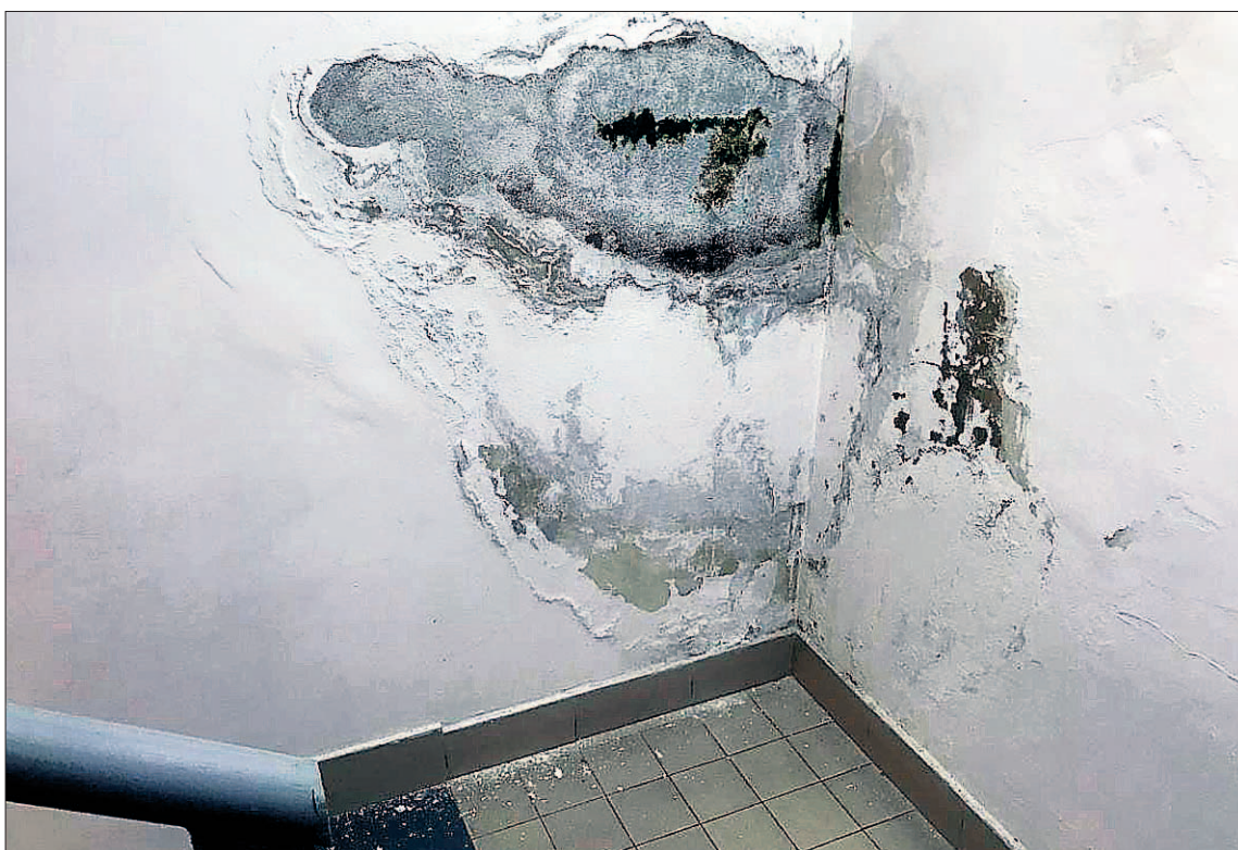
Humedades que presenta el aparcamiento de José Zorrilla y que están siendo eliminadas por operarios municipales. / E. A.
