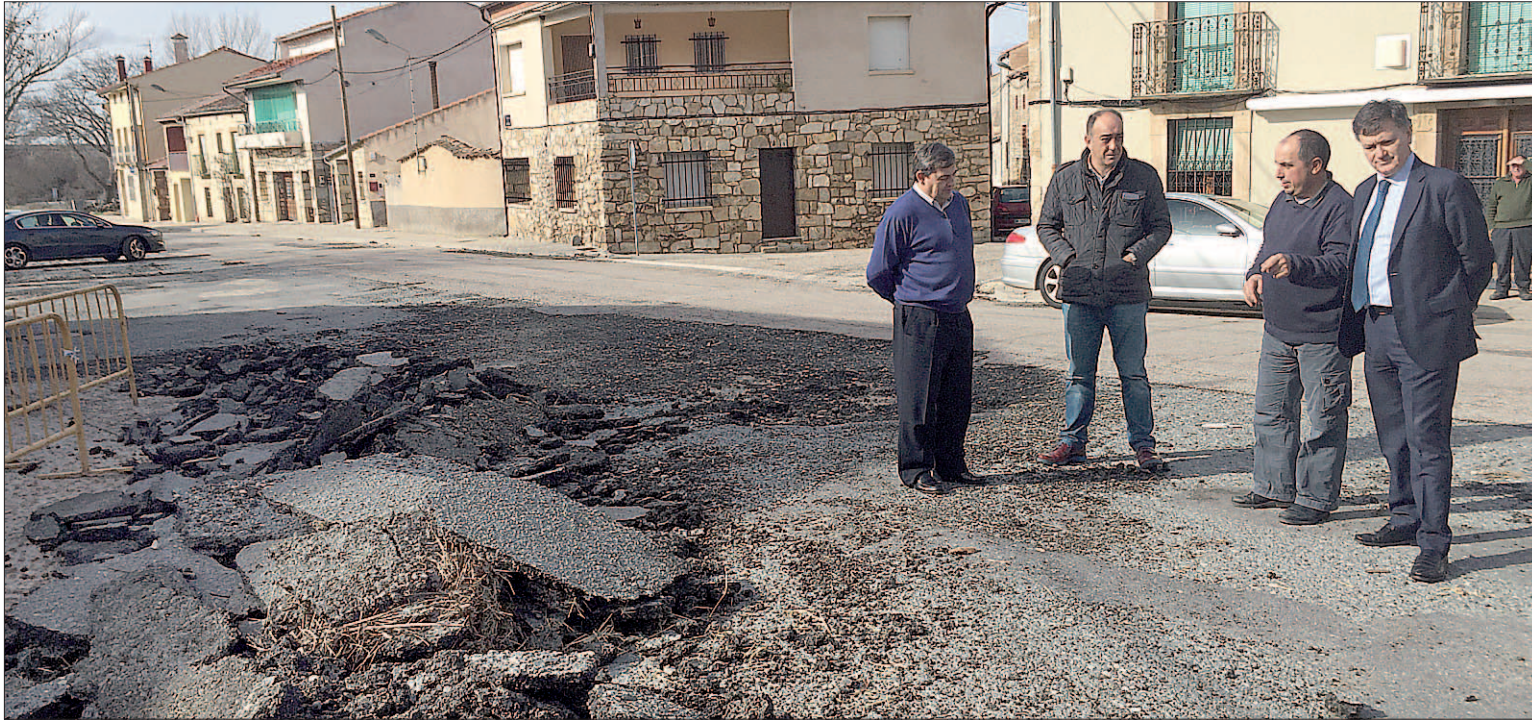
El presidente de la Diputación, durante la visita que realizó hace dos años para ver los desperfectos causados por el agua. / EL ADELANTADO
