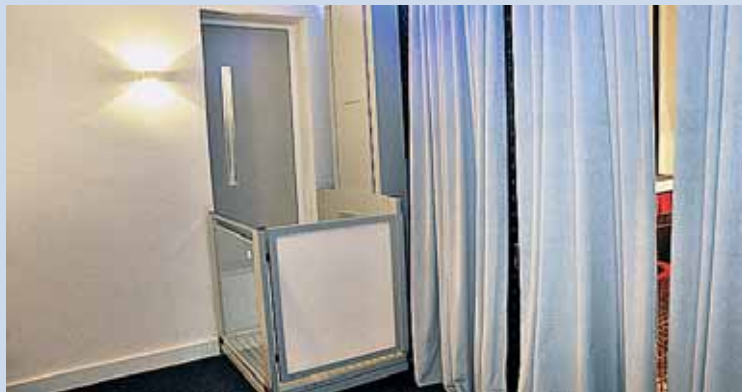
PLATAFORMA ELEVADORA. Permite el acceso al escenario del teatro Juan Bravo de personas con movilidad reducida.
