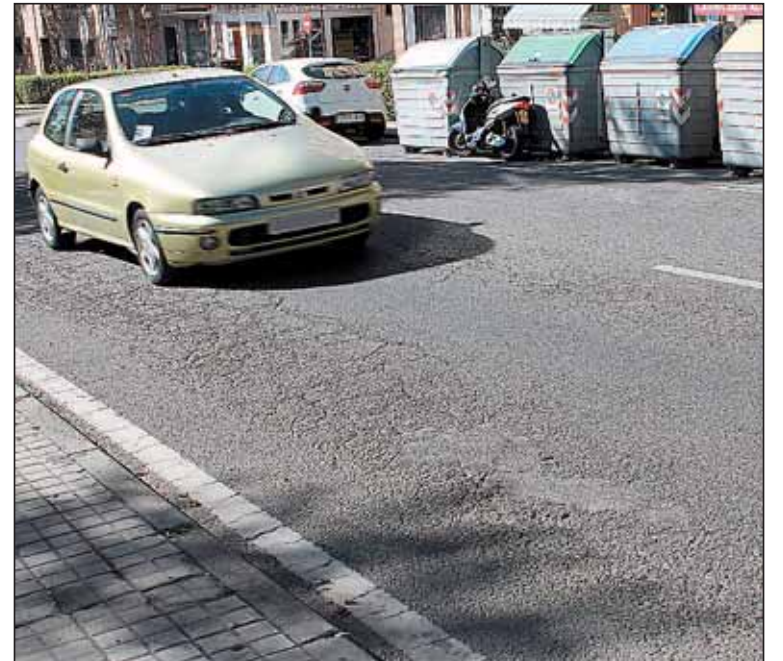
La carretera de Villacastín ofrece un estado de conservación preocupante.
