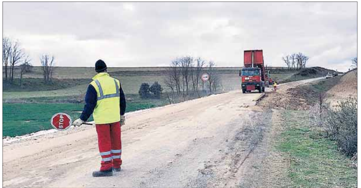
Los operarios realizan las indicaciones oportunas a los conductores mientras duren las obras. / EL ADELANTADO
