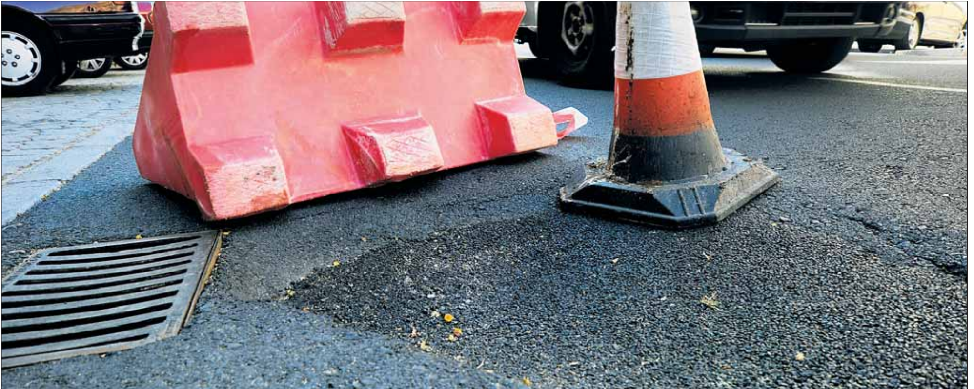
Un cono indica en la avenida de la Constitución uno de los hundimientos detectados en los últimos días, precisamente en una zona donde ya se intervino el invierno pasado por un problema similar. / KAMARERO
