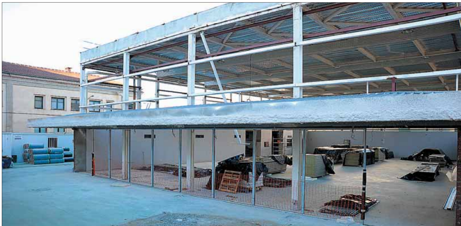
Los trabajos pendientes son los más vistosos ya que se sitúan en la fachada y en la colocación de los paneles aislantes que recubren las paredes exteriores. / KAMARERO
