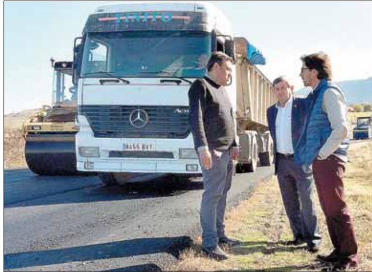
Autoridades provinciales y municipales visitaron la marcha de las obras. / E. A.
