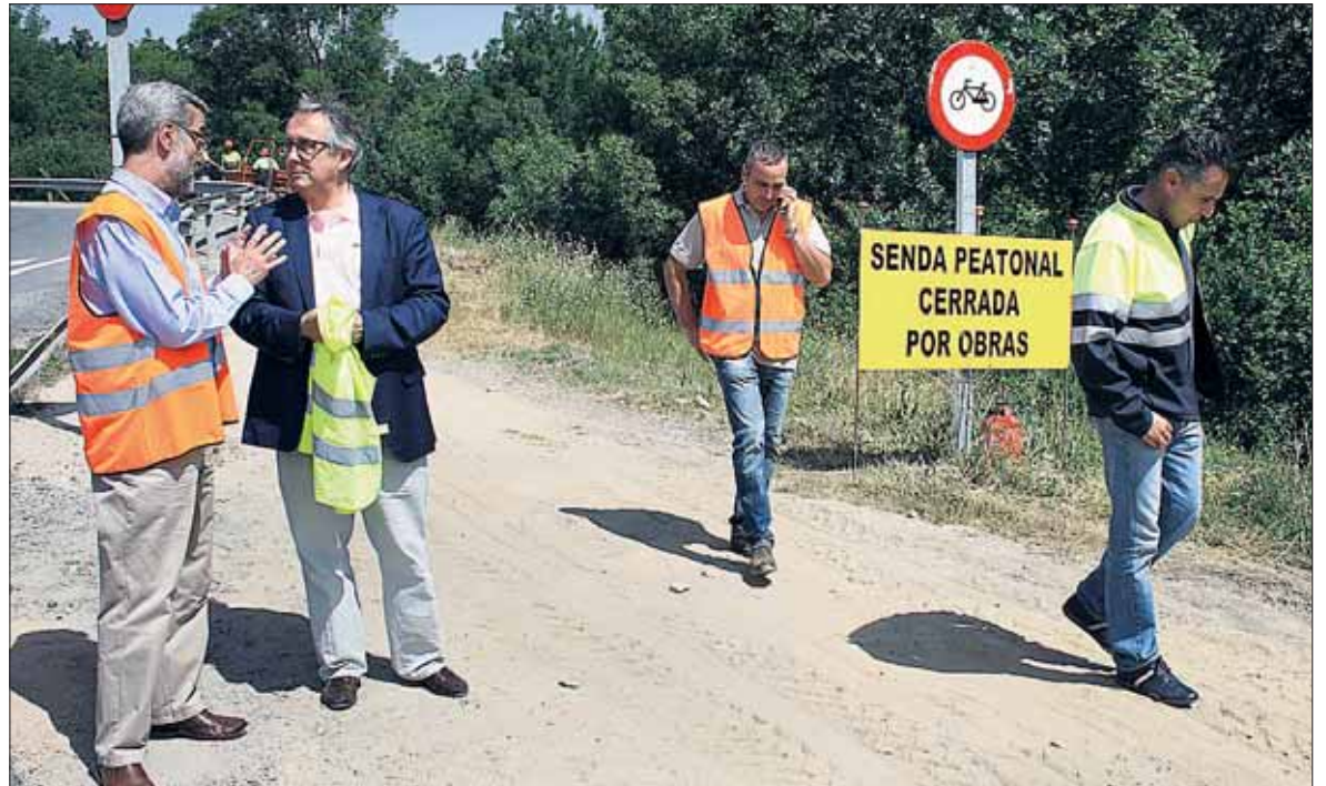
López Escobar (segundo por la izq.) con Arranz (primero por la izq.), supervisando las obras. / EL ADELANTADO
