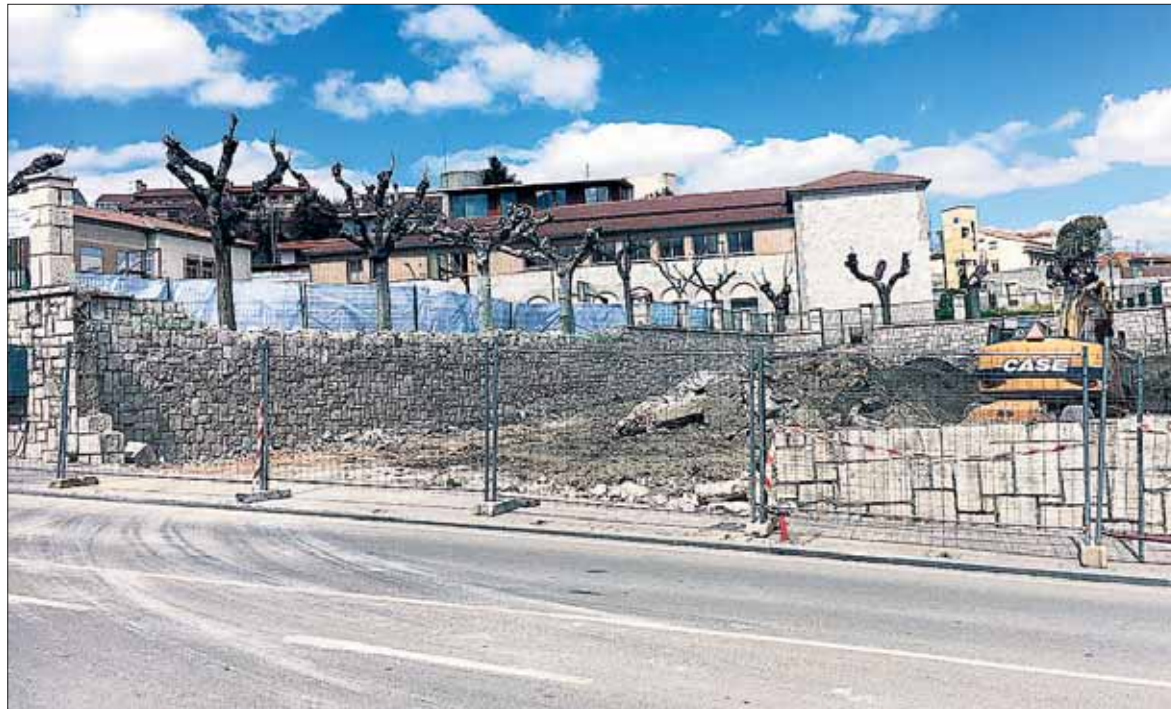
Estado actual en que se encuentran las obras del gimnasio del colegio 'La Villa'. / CHANTAL NÚÑEZ
