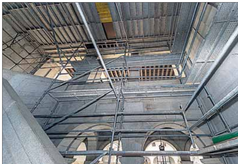
También se trabaja en reparar el techo de la escalera del Patio de Honor. / KAMARERO
