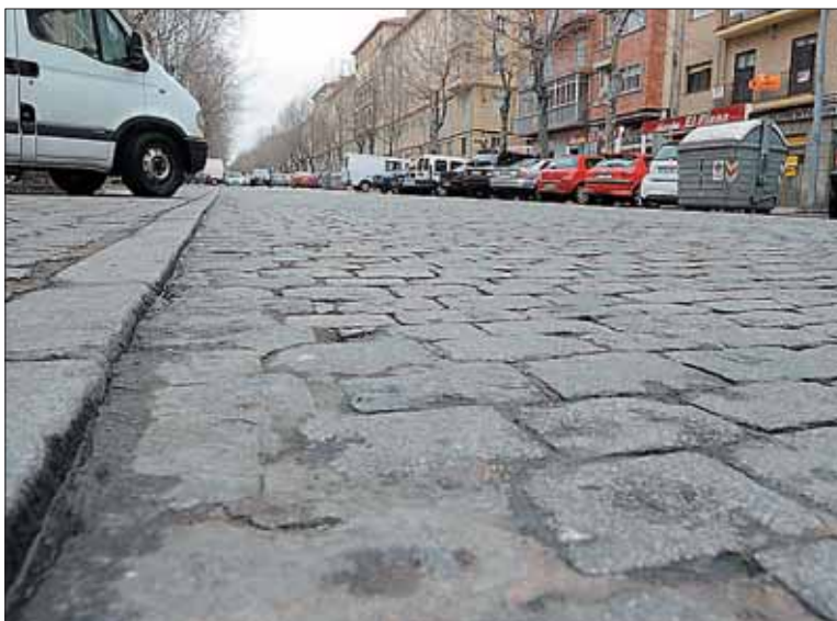
El pavimento de esta céntrica avenida está muy deteriorado. / KAMARERO
