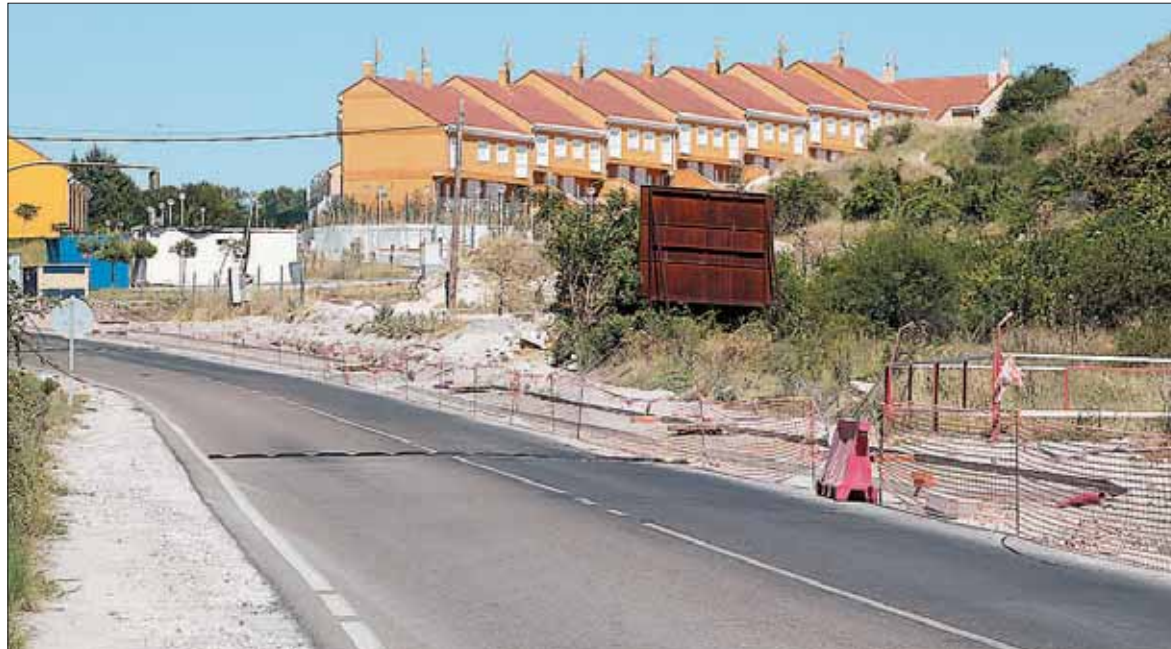
La construcción de la acera, inexistente, permite mayor seguridad a los peatones y vehículos. / C.N.
