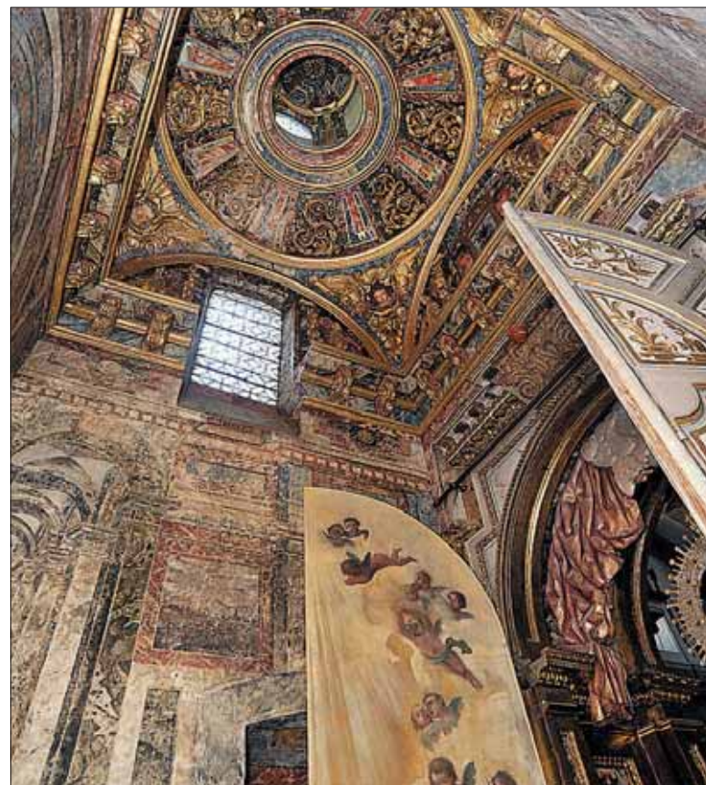
El PP ha logrado el apoyo del Ayuntamiento para reparar el camarín. / KAMARERO
