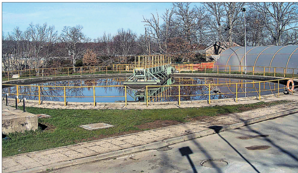
La CHD tiene previsto remodelar y ampliar la depuradora de La Granja en 18 meses. / EL ADELANTADO
