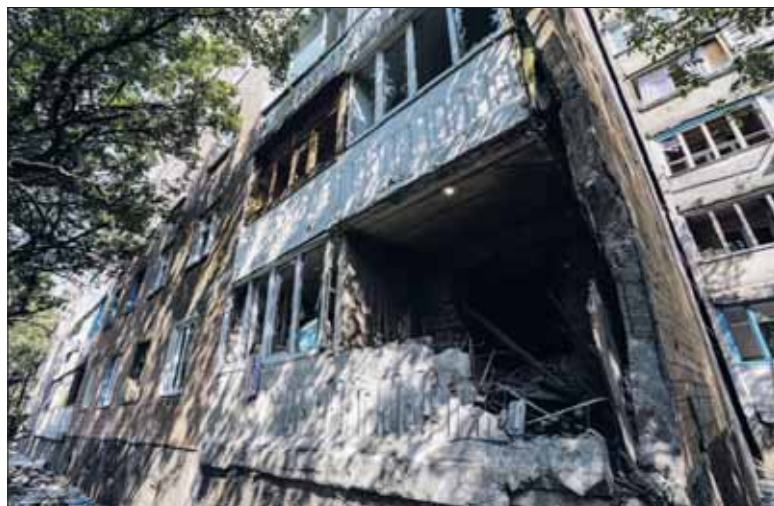
Un edificio del centro de Donetsk devastado por el impacto de un misil. / EFE
