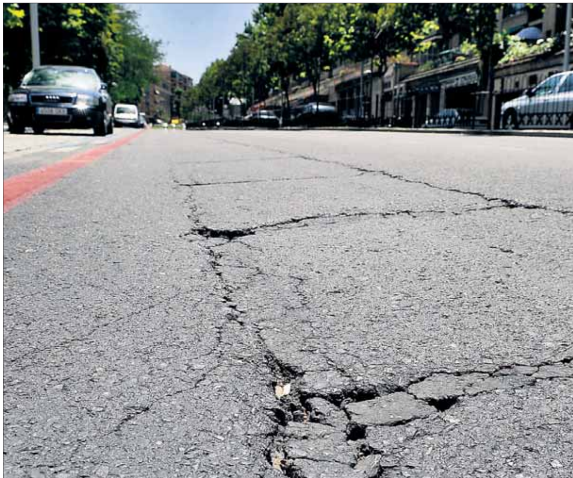
Vista parcial del asfalto de un tramo del paseo Ezequiel González, donde se aprecian grietas por hundimiento. / KAMARERO
