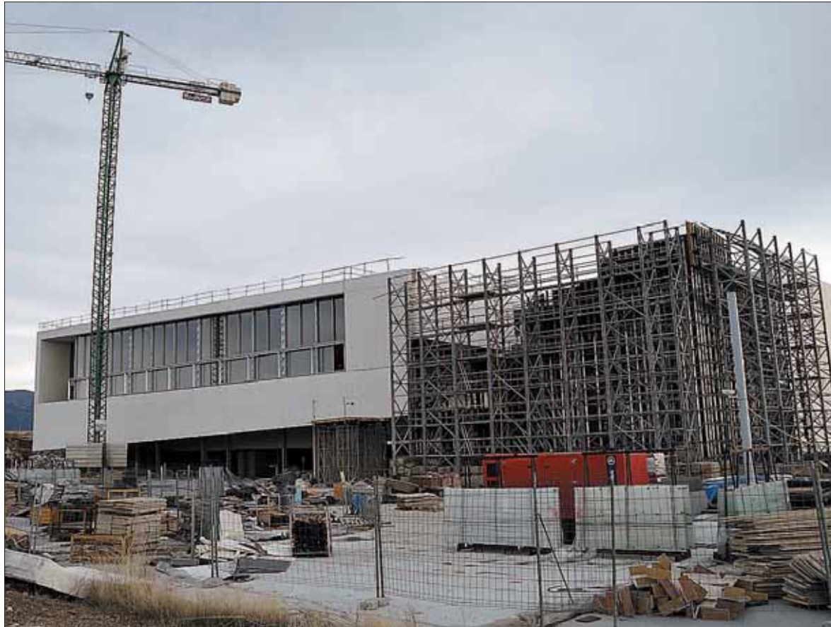
Las obras del primer edificio del CAT llevan paralizadas desde junio de 2013. / JUAN MARTÍN
