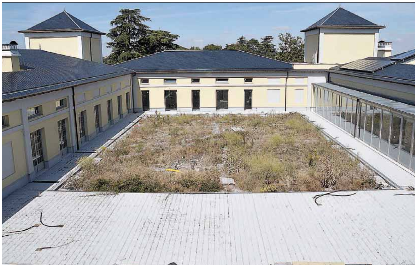
El patio del edificio de La Faisanera presentaba ayer este aspecto a la espera de que hoy mismo comiencen las obras./ JUAN MARTÍN
