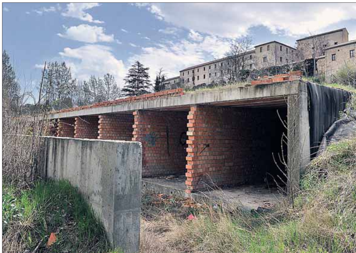
Estado que presentan en la actualidad algunas de las edificaciones ilegales de Hontanilla de Santo Domingo. / KAMARERO
