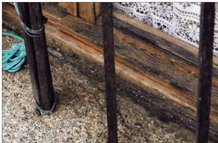
Ventana afectada por el silencioso trabajo de las termitas. / EL ADELANTADO
