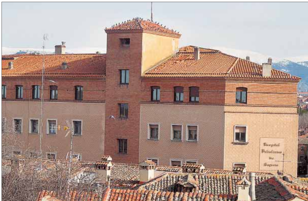
Colonias de palomas han tomado la cubierta de la torre central del antiguo Hospital Policlínico. / EL ADELANTADO
