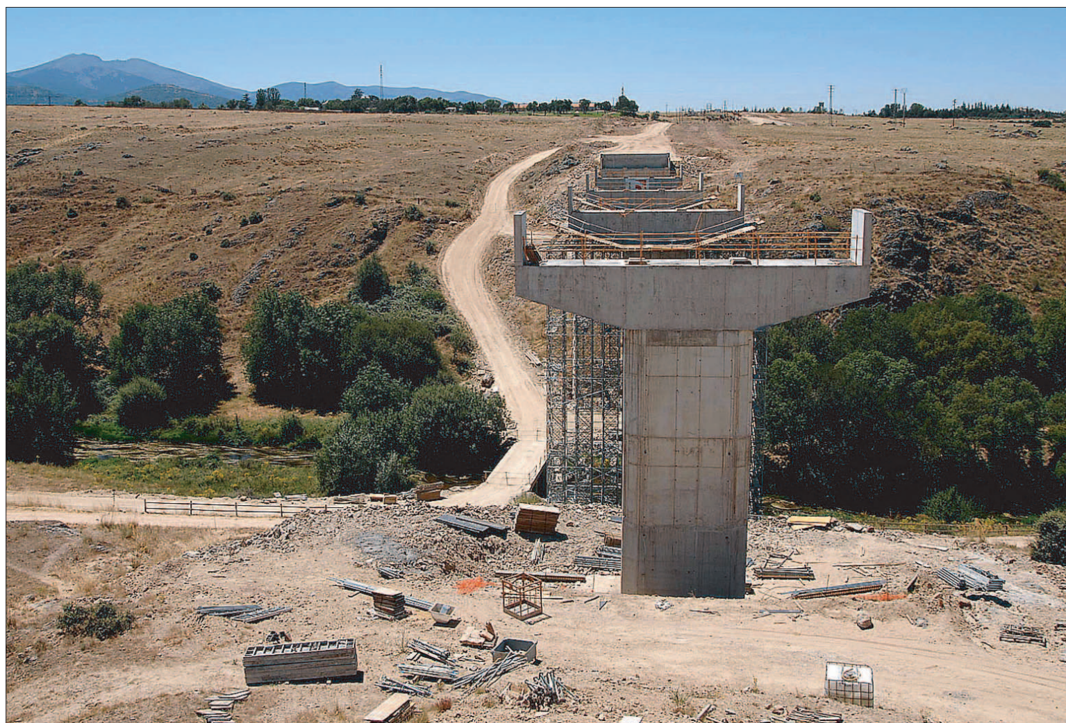
Ya se han instalado los cinco pilares que soportarán el puente de unos 150 metros de longitud que incluye la obra. /ALBERTO BENAVENTE
