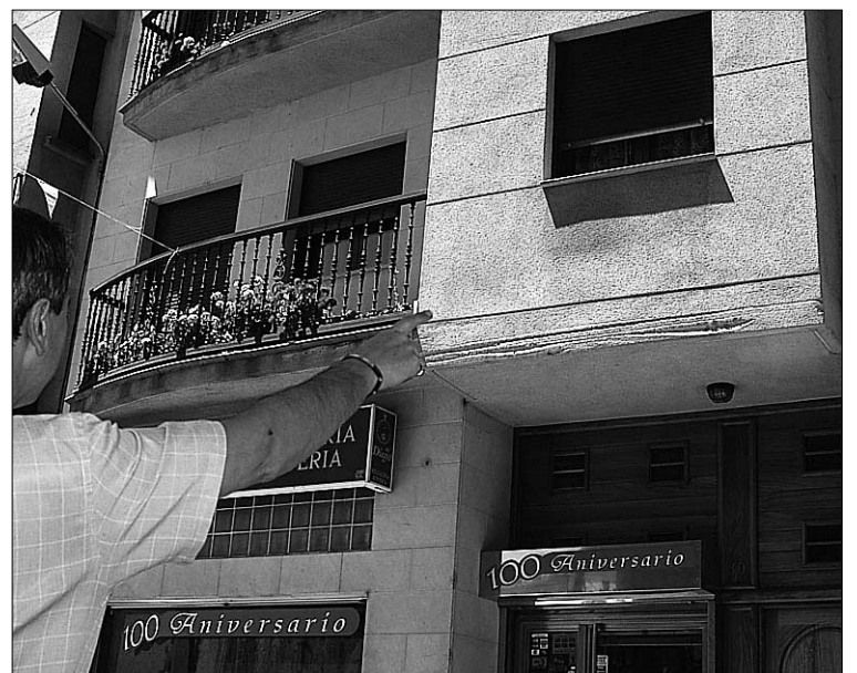
Una persona señala uno de los muchos desperfectos realizados por los camiones que pasan por la travesía de Cantalejo, debidos a la estrechez de la vía. / G. HERRERO.
