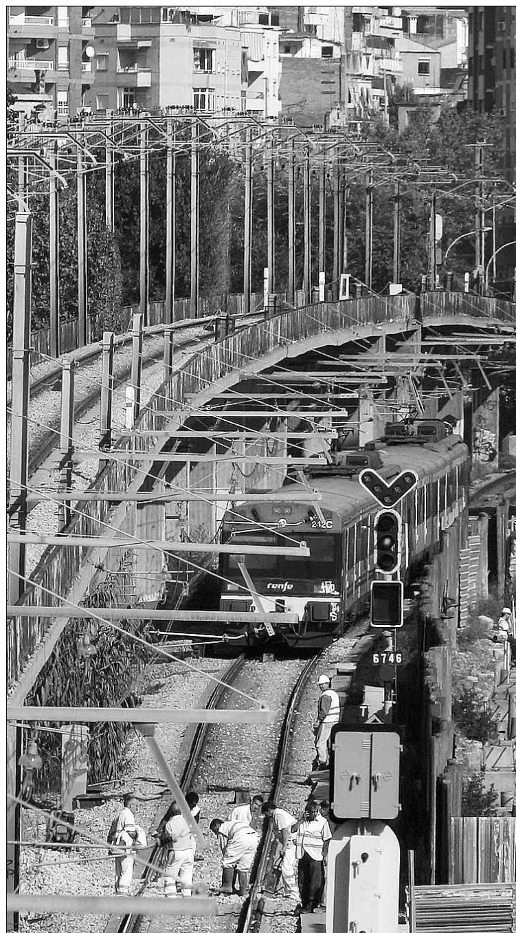
La aparición de una decena de socavones ha paralizado las obras del AVE. / EFE
