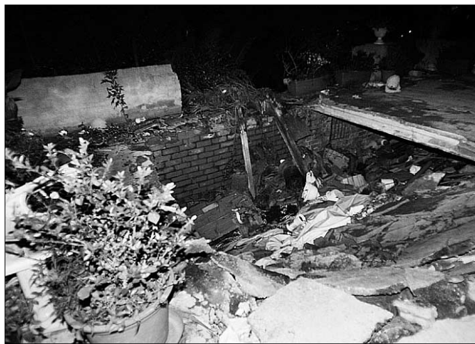
La terraza quedó reducida a escombros debido al peso de la piscina. / EFE
