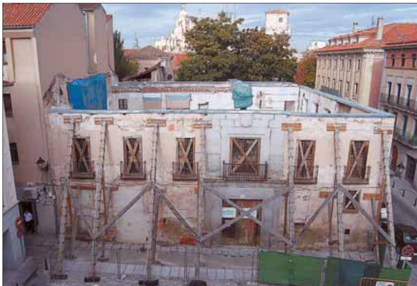
El proceso judicial paralizó la operación comercial del edificio que ocupó el Palacio de Enrique IV. // JUAN MARTÍN
