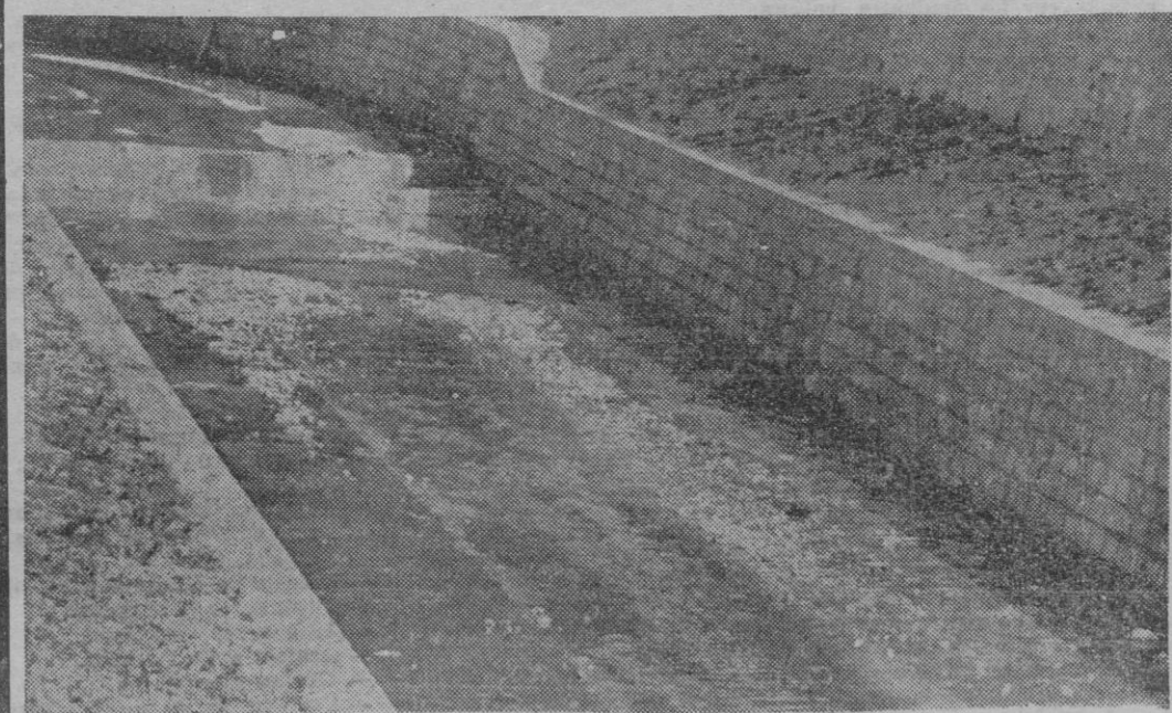
A punto de terminar las obras del adecentamiento del cauce de la Riera, llegaron las lluvias. Abundantes, por otra parte. Y cuando aun fluye la resaca de los aguaceros caídos, sobre las diferentes gradinatas del álveo de la Riera, aparecen los acarreo de la última avenida.
