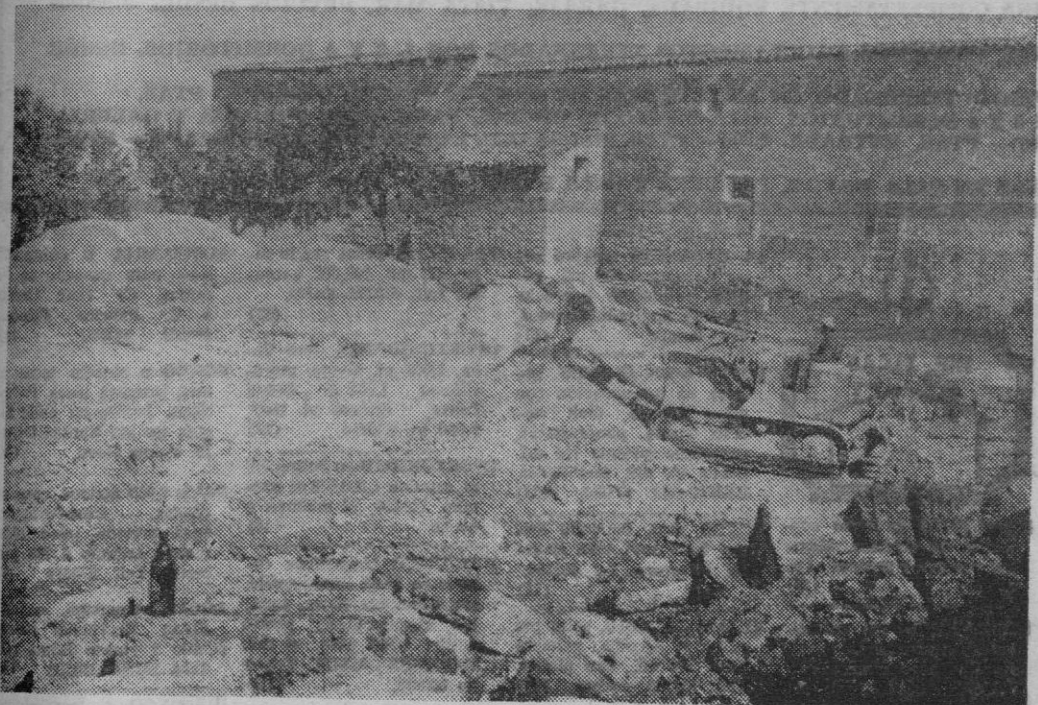
Sobre el telón de fondo que forma el muro del convento de las Religiosas Jerónimas, podemos ver en acción a las potentes máquinas que van excavando lo que, en un futuro inmediato, será el nuevo depósito regulador de agua. Una importante mejora para la ciudad, cuya realización merece unánimes aplausos por parte del vecindario. -- (Reportajes Payeras.- Inca).
