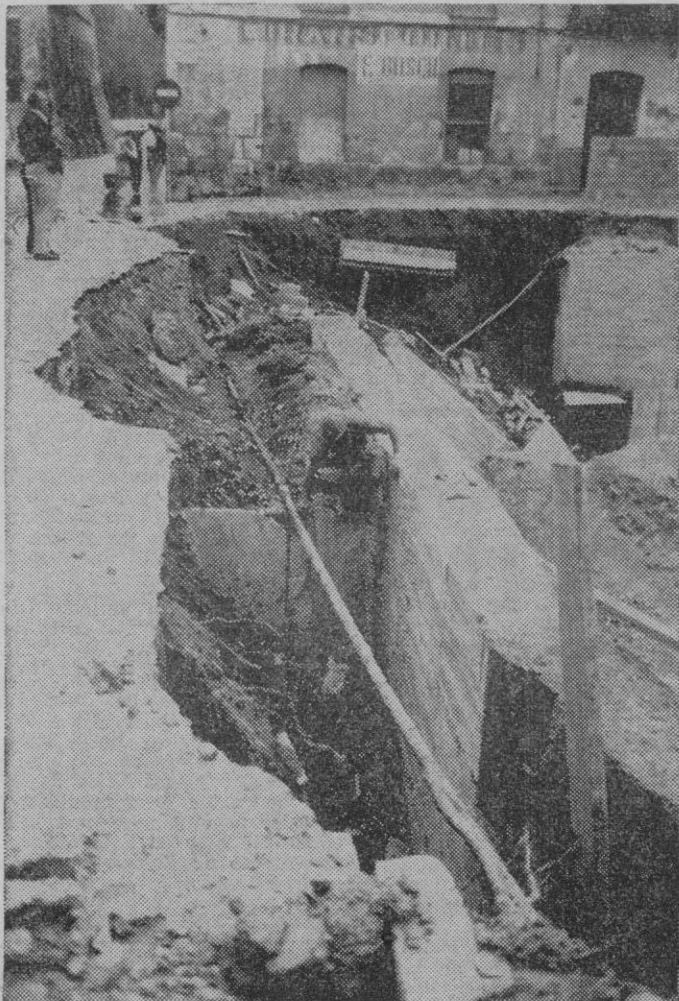
Ayer se desprendió uno de los muros de contención que se levantaron en las excavaciones que se llevan a cabo en la Plaza Obispo Berenguer de Palou para la instalación de un aparcamiento subterráneo, situado a la vereda de la calle Falangista Laportilla, cerrada al tráfico en las últimas fechas.
