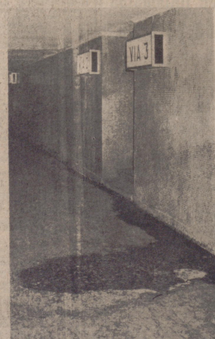
Los pasos subterráneos de peatones presentan un deficiente estado.
